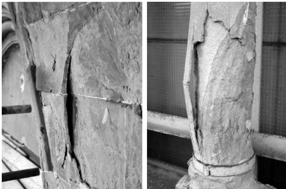
Gravi fenomeni di scagliatura spinti fino al distacco di parti di materiale
